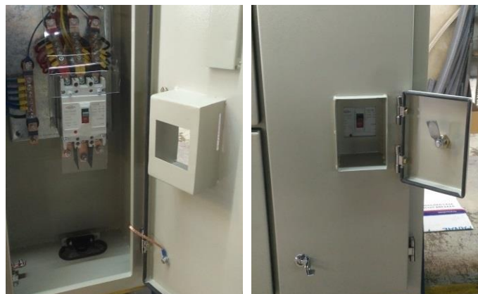
شکل ۲: دریچه قطع و وصل کلید اتوماتیک
